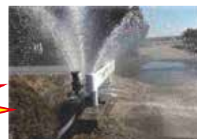
水管橋の漏水
