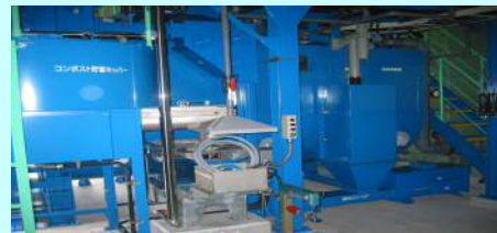
コンポスト化施設内部
